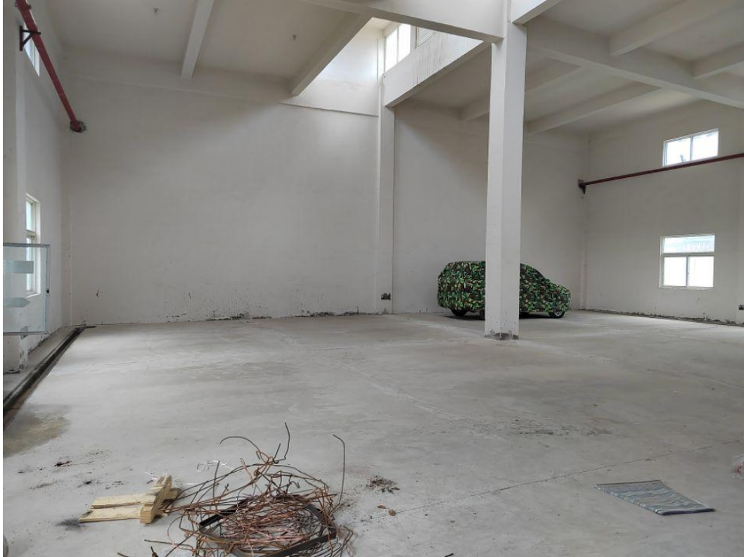
车间内现场照片
