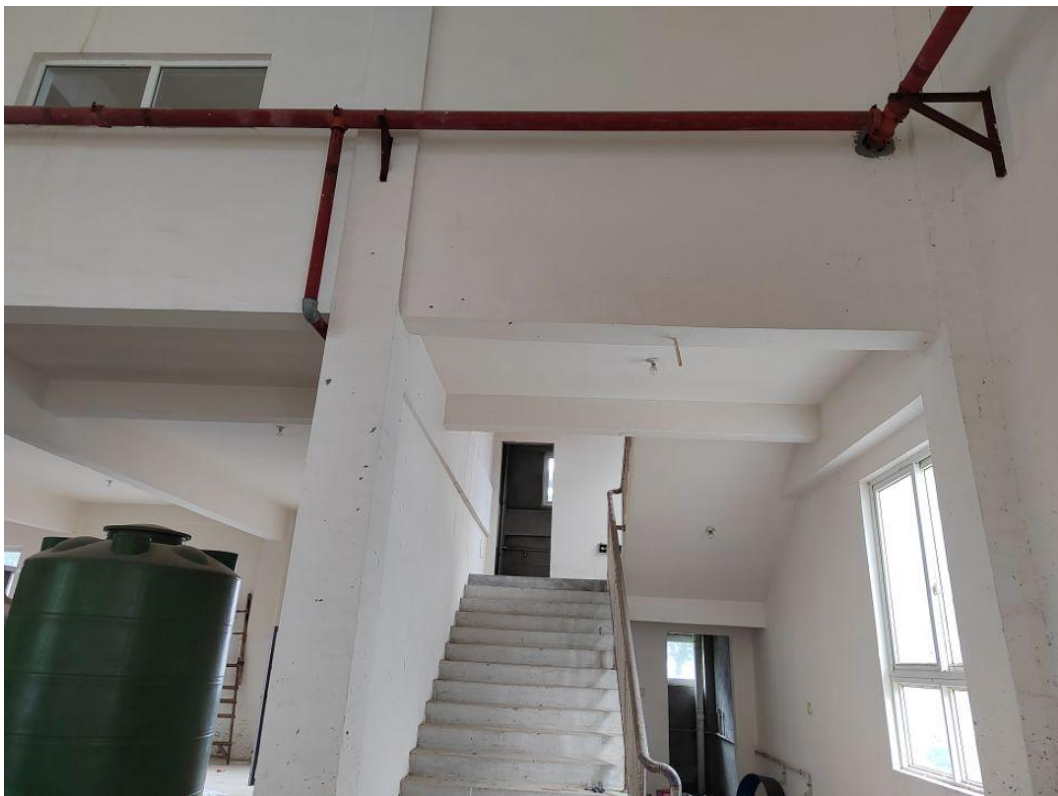
车间内现场照片
