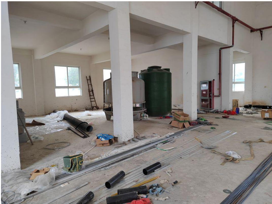
车间内现场照片
