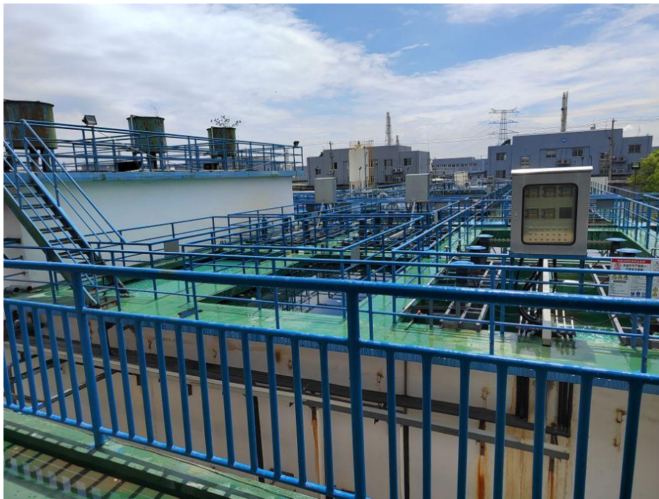
润埠污水处理站照片
