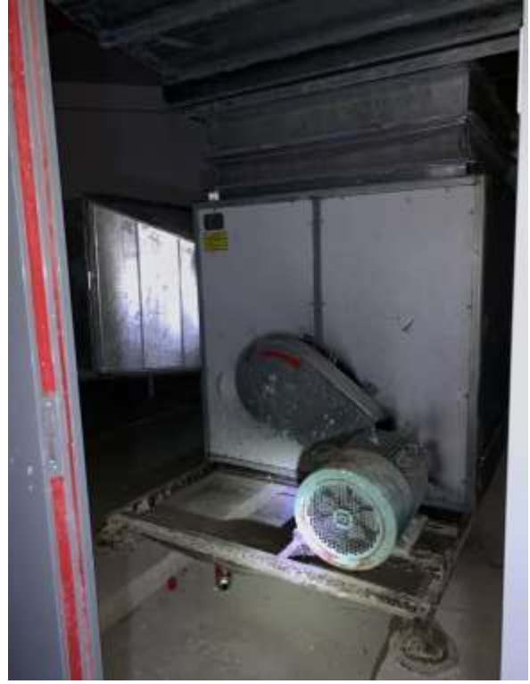
地下车库换风系统
