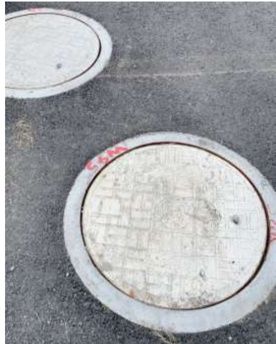
雨水井、污水井
