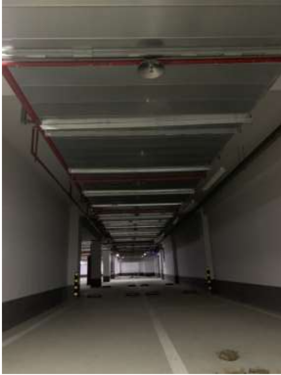
地下车库风管
